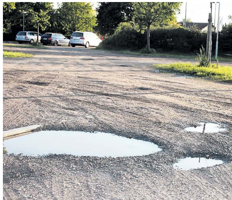
Schlaglöcher: Der Parkplatz im Leutershausener Sportzentrum gleicht derzeit einer Buckelpiste. Die Gemeinde verspricht Abhilfe.
